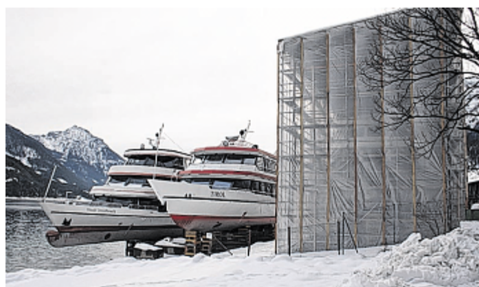
Neben den beiden Achenseeschiffen Tirol und Stadt Innsbruck sind seit November die Schiffsbauer am Werk. Noch ist die Baustelle verhullt.
