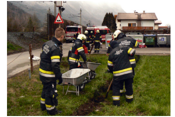
Das ölverschmierte Erdreich musste abgegraben werden.
