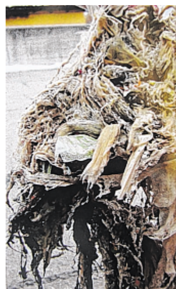
Zahlreiche Dinge, die im Abwasser nichts verloren haben, verstopften die Pumpen. Foto: Gemeinde Strass
