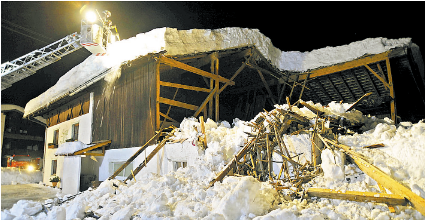
Das Dach einer Scheune in der Leutasch konnte die Schneelast nicht mehr tragen. Es stürzte ein und begrub einige Maschinen unter sich. Foto: Zoom-Tirol
