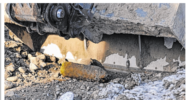
Unter der Baggerschaufel liegt keine Granate, sondern ein mit Erdreich gefülltes Metallrohr.
