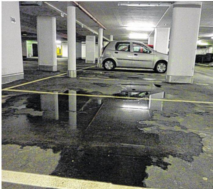
In der Tiefgarage unter dem Seniorenheim in Vomp bilden sich immer wieder tiefe Wasserlachen. Foto: Stecher
