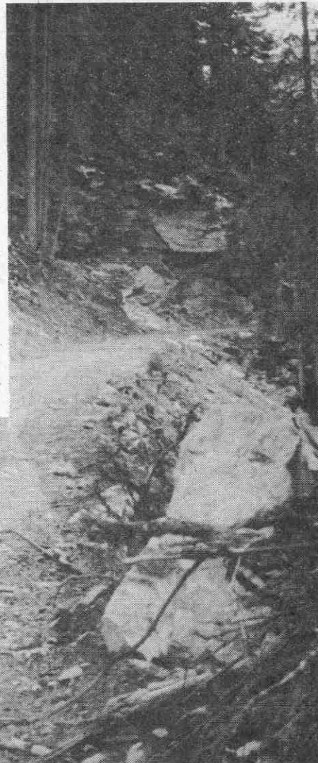
Der im Bau befindliche Forstweg im Verwall, der zugleich der Bewirtschaftung der »Zwei Drittel Alm« dient.
