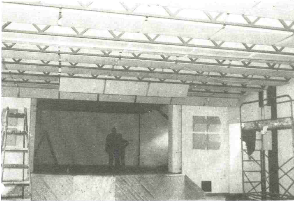
Der von Architekt Dipl.-Ing. Fritz Falch geplante Umbau kurz vor der Fertigstellung
