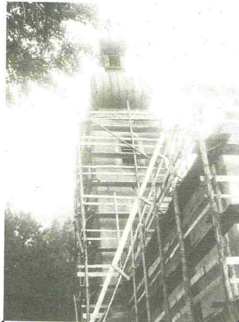
Der Putz muß runter!
