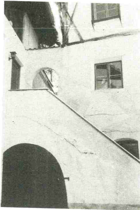
Der Rutschhang hat das Gerberhaus schon ganz zerrissen.
