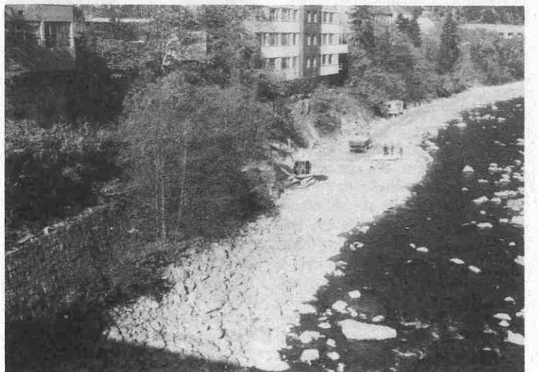
Unterhalb des Gröbnerhauses hat der Mauerfuß einen Bewuchs. Fotos Perktold
