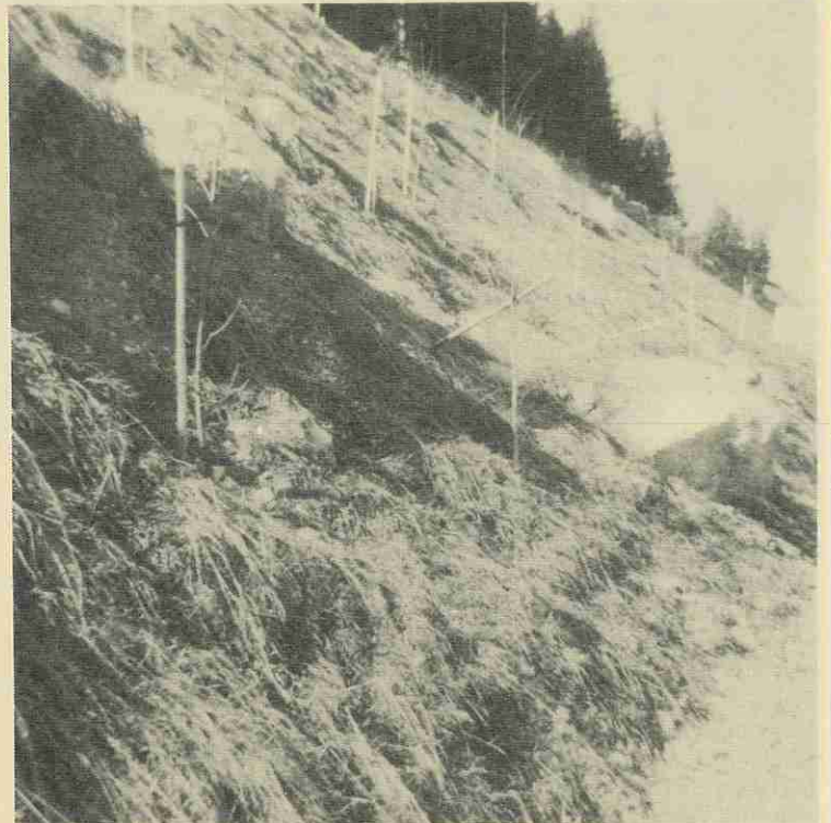
Etwas „ungenauere Böschung“ bei Lofer (Salzburg)
