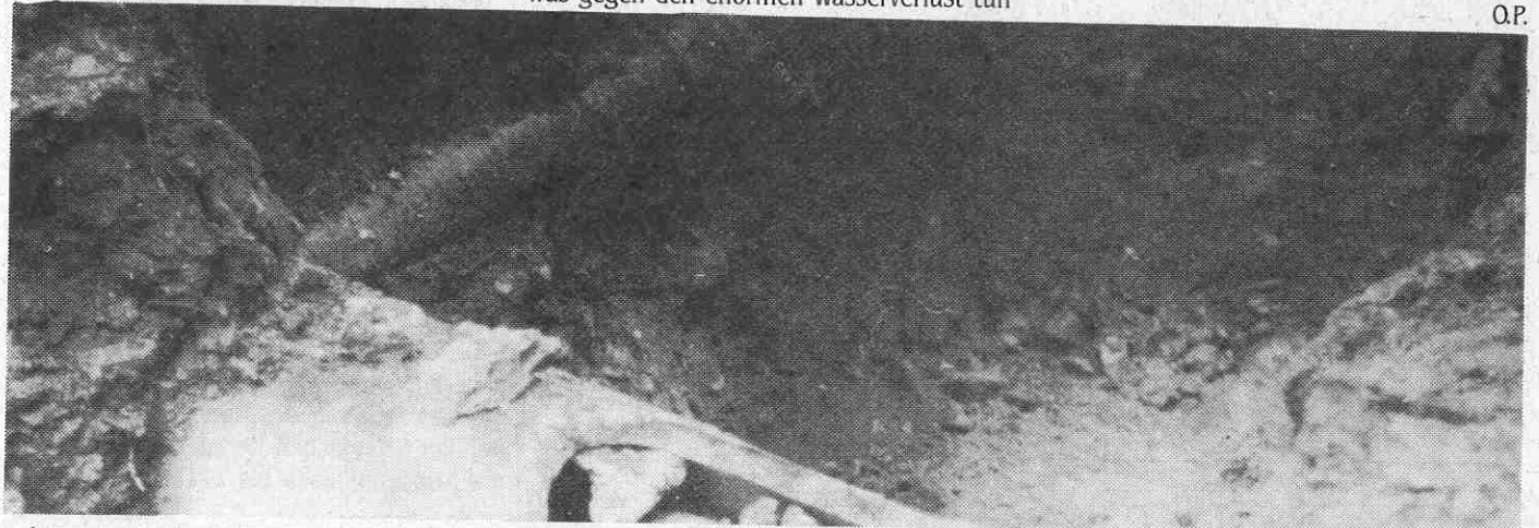
Bei den Aushubarbeiten zur neuen Wasserleitung kam auch die alte Leitung, die bis 1961 in Verwendung war, zum Vorschein.
