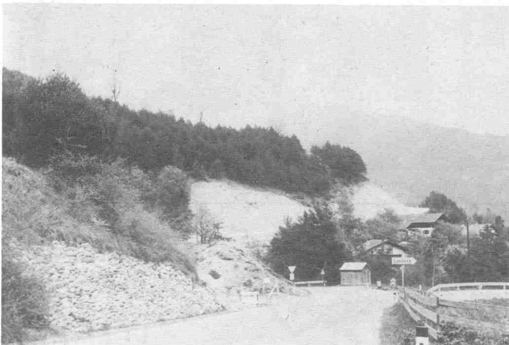
Die Stanzer Landesstraße – hier die Abzweigung von der Grinner Landesstraße – ist bis zum Leitenbauer im Rohbau gediehen.
