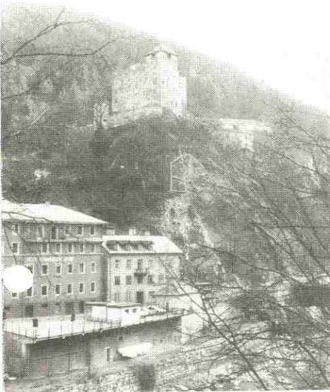
Die statische Sicherung des Schoßfelsens, von dem letztes Jahr ein Stück brach und ein darunterliegendes Gebäude zerstörte
