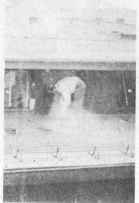
Die Freiheit auf den Dächern: Asbestzementfeinstaub erzeugung (Aufnahme: 5.11.1987, 8.30 Uhr, Landeck, Malsler Straße 20).
