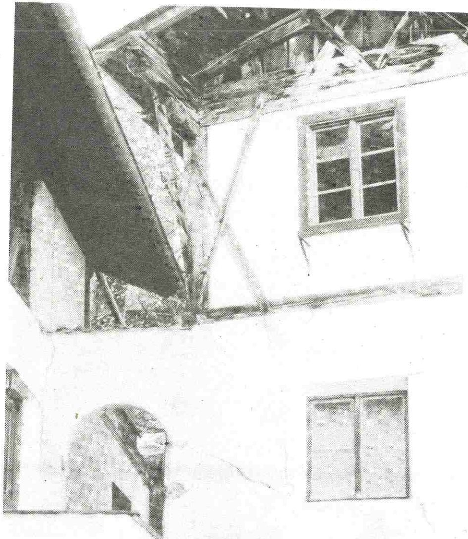
Die Verbindungsstelle zwischen altem und jüngerem Hausteil: der schneller abrutschende linke Teil reißt den rechten mit.
