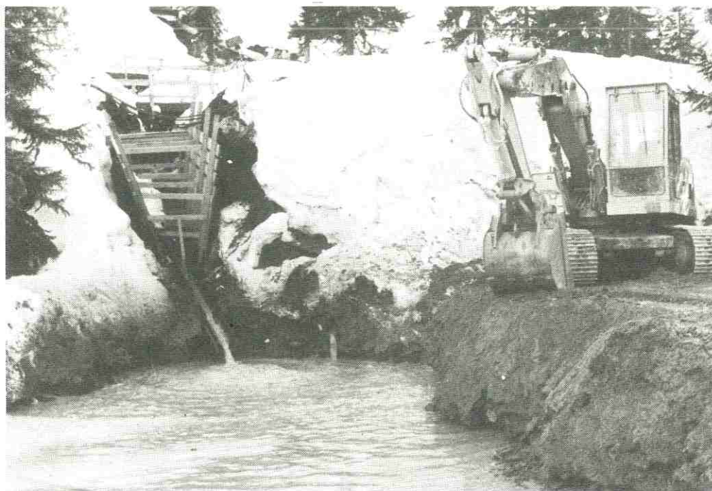
Das Schlamm-Absetzbecken ist viel zu klein;
