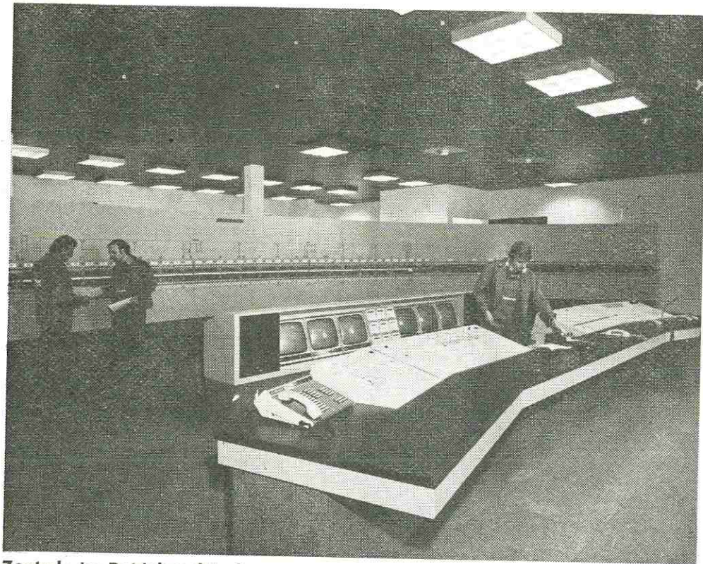
Zentrale im Betriebsgebäude
