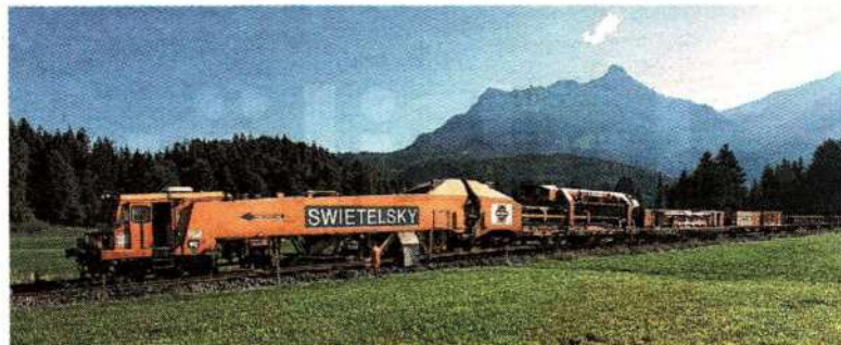
Große Gleisbaumaschinen prägten das Bild entlang der Bahnstrecke bei Vils. Foto: ÖBB
