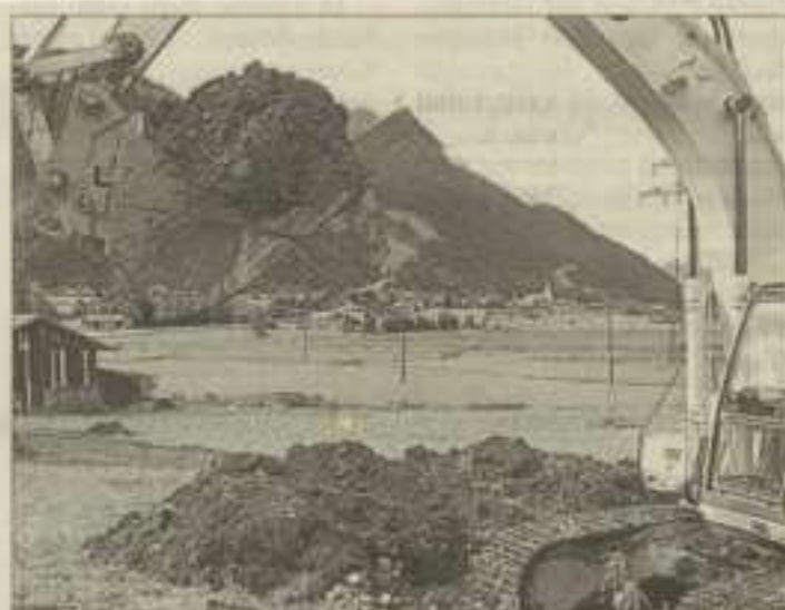
AM NEUEN KANAL in Lahn wird bereits gearbeitet. 2001 soll es dann „Abwasser marsch!“ heißen.
