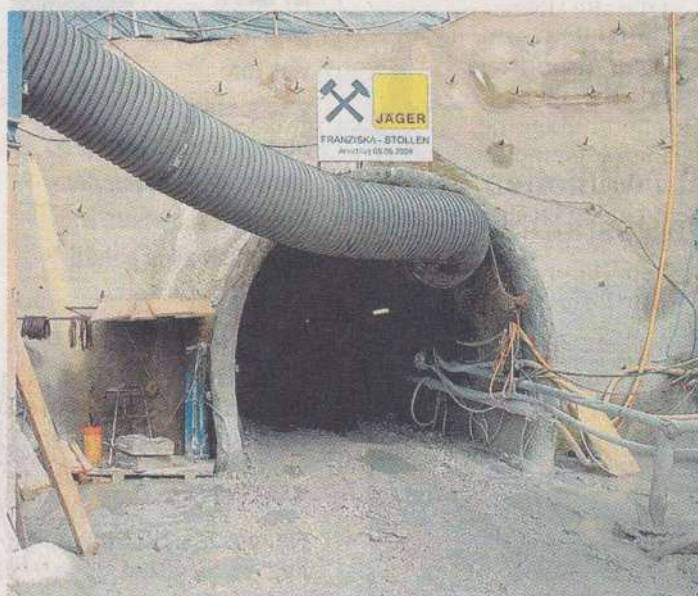
Parallel zum Grenztunnel graben sich die Bautrupps seit Monaten durch den Fels. Anfang 2009 ist der Fluchtweg fertig. Foto: Bader
