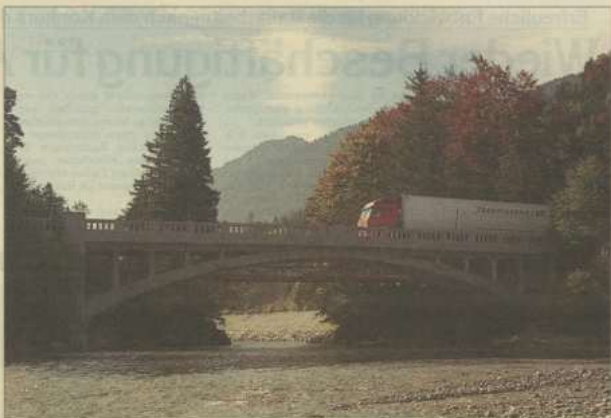
Die Ulrichsbrücke wird derzeit saniert und bleibt in Zukunft für Radfahrer und Fußgänger erhalten.
