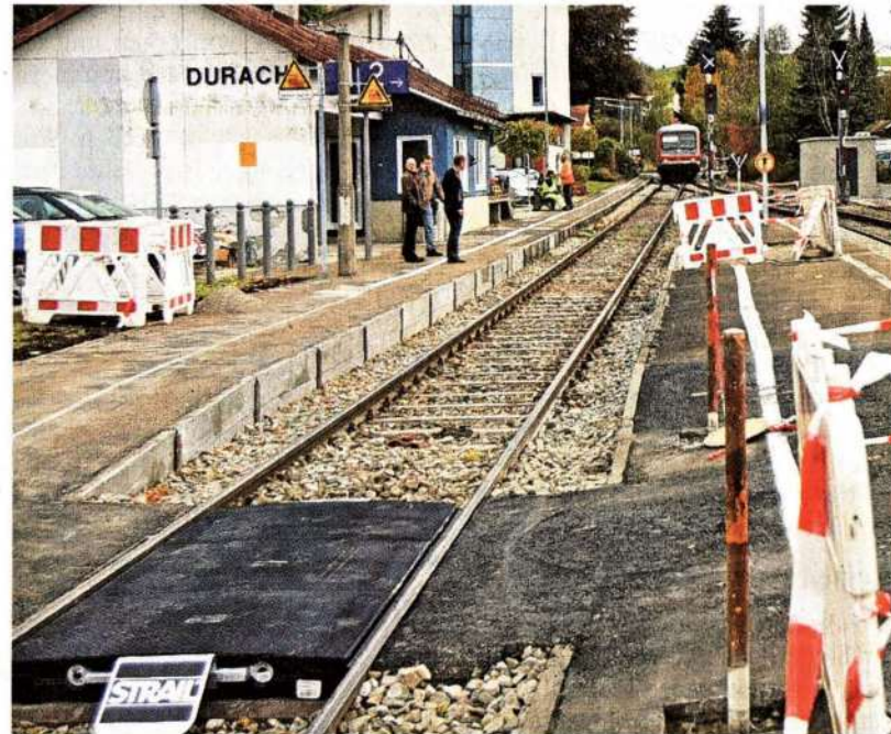
Künftig werden auf der sogenannten Außerfernbahn (Richtung Reutte) Weichen, Signale und Schranken von einem elektronischen Stellwerk vom Bahnhof Durach aus gesteuert.
