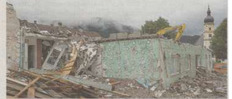
Die Abrissarbeiten rund um den „Grünen Baum“ prägen derzeit das Stadtbild von Vils.
