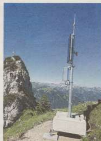
Am Füssener Jöchle wurde für die digitale Erreichbarkeit ein Funkgateway installiert. Fotos: Privat
