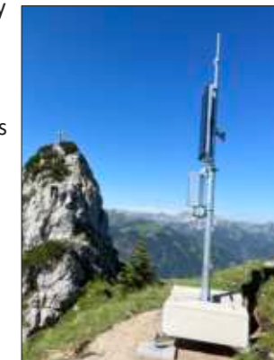
Das fertige Gateway ist einsatzbereit.
