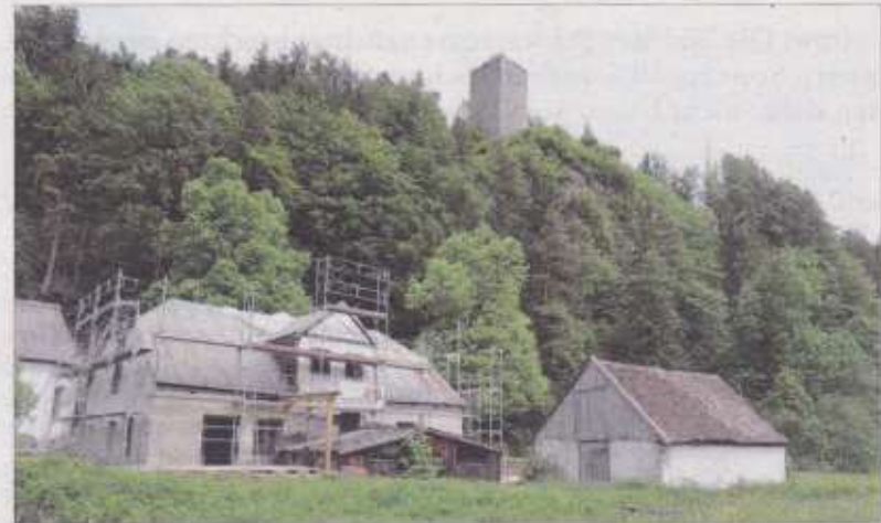
Eine Außenansicht der Hammerschmiede – mit Kohlespeicher daneben – und der Ruine Vilsegg im Hintergrund.
