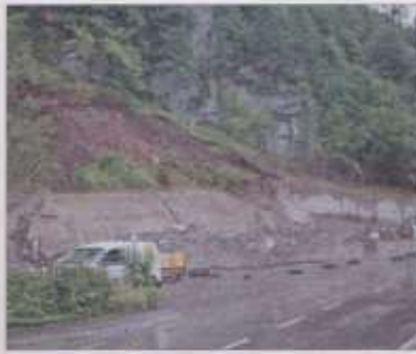
Ein Bild der Zerstörung präsentierte sich beim Weißhaus in Pinswang. Etliche Kubikmeter Erde und Geröll brachten die betonierte Hangsicherung zum Bersten. Foto: Schrettl
