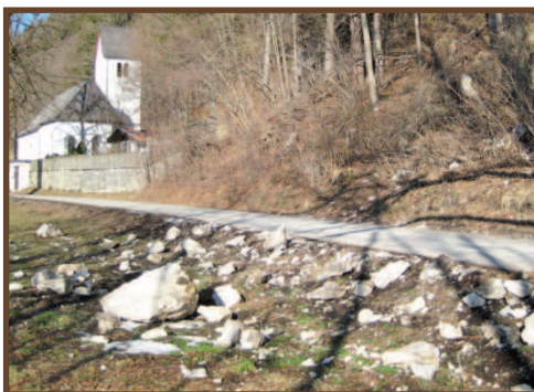
Auf Grund eines Felssturzes musste die Straße nach St. Anna gesperrt werden. Dank Gemeinde und Bergwacht konnte der Hang gesäubert und gesichert werden.
