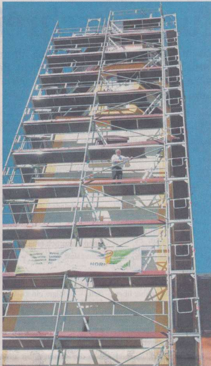
Pfarrer Rupert Bader klettert fast täglich selbst bis auf die Kirchturmspitze, um sich über den Baufortschritt zu informieren. Foto: Schrettl
