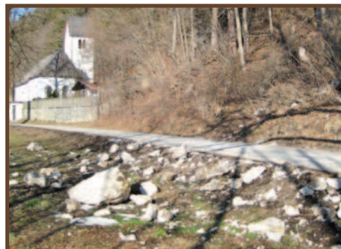
Auf Grund eines Felssturzes musste die Straße nach St. Anna gesperrt werden. Dank Gemeinde und Bergwacht konnte der Hang gesäubert und gesichert werden.
