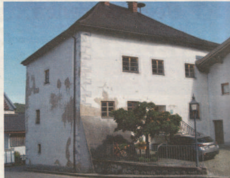
Das Schlössle ist zumindest von außen in einem erbärmlichen Zustand.
