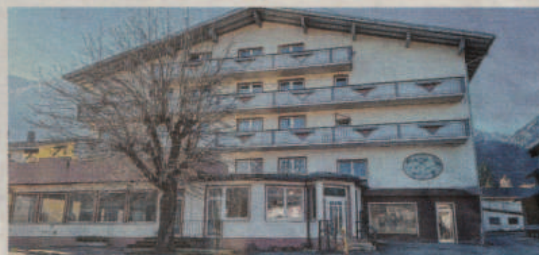
Seit Jahren steht der Grüne Baum schon leer. Bgm. Immler geht vom Abriss des Schandflecks Anfang nächsten Jahres aus.
