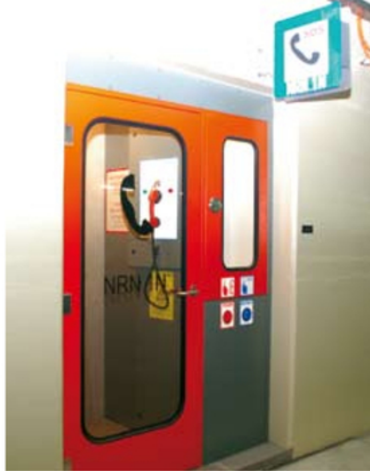
Die Notrufboxen entsprechen den modernsten Standards in Tunnelbauten.
