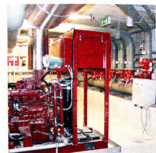
Sprinklerzentrale im Kellergeschoß
