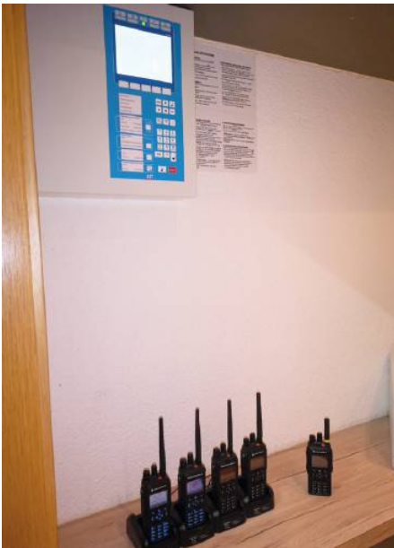
Die Brandmeldezentrale wurde in der Florian-Station eingebaut.
