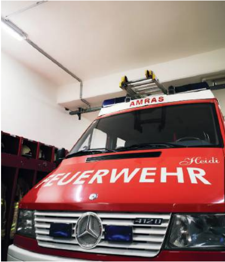
Der Brandmelder über dem KLF der Feuerwehr Amras in der Fahrzeughalle.
