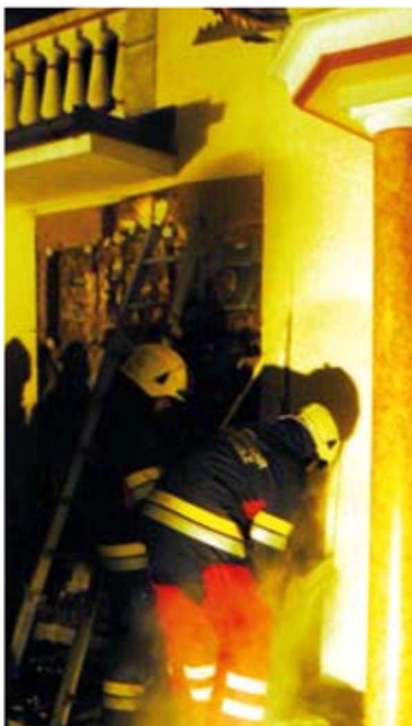
Ein großes Stück der Fassade musste aufgeschnitten werden, um an die Glutnester zu kommen!
