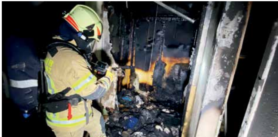
Der Brand wurde rasch unter Kontrolle gebracht – die Schäden waren allerdings enorm.
