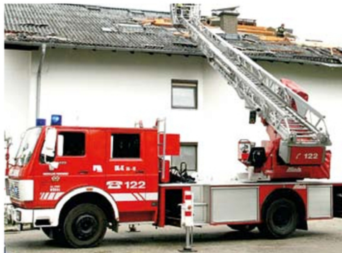
Abgedeckte Dächer infolge starker Windböen gab es in Wörgl!
