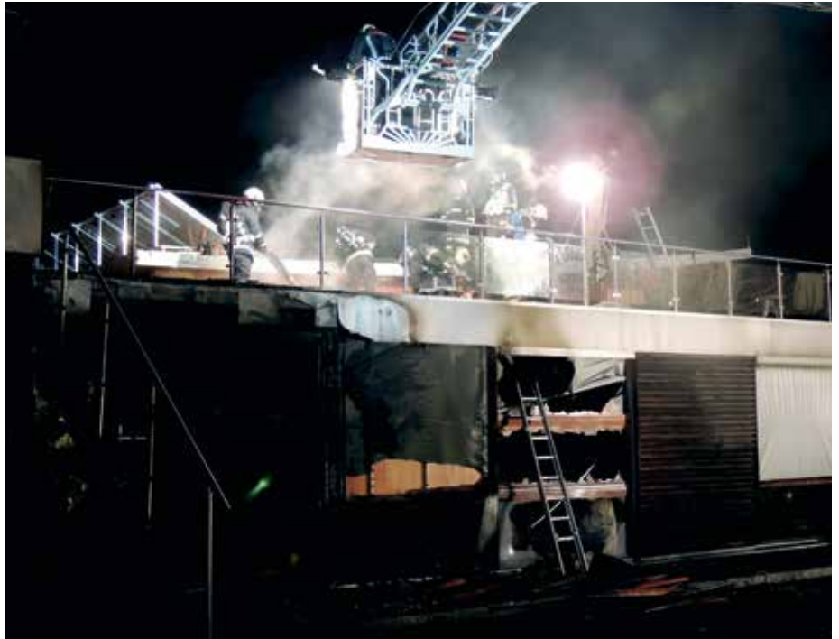
Die Dachhaut wurde geöffnet – der Brand konnte endgültig unter Kontrolle gebracht werden.
