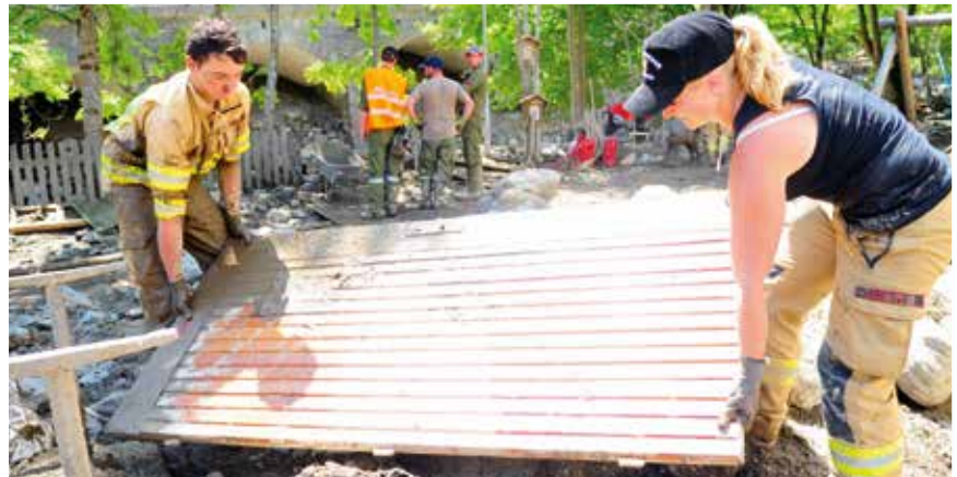
Nicht nur im Inneren der Häuser, sondern auch außerhalb gab es jede Menge Arbeit. Tagelang standen die Feuerwehrmitglieder und andere Einheiten im Einsatz.
