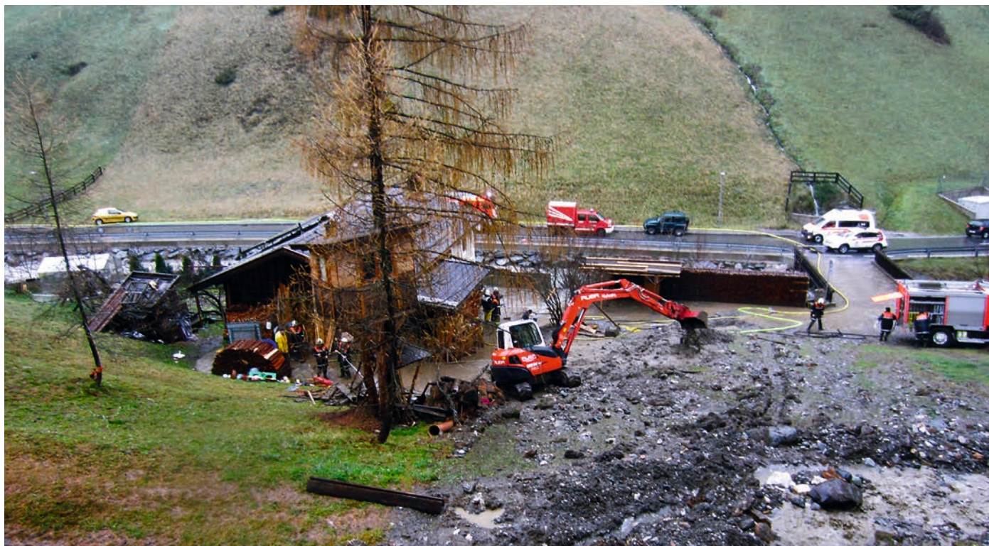
Eine Mure drang in das Wohnhaus in Gries am Brenner ein und erforderte Sofortmaßnahmen wie die Errichtung eines Schutzdamms.
