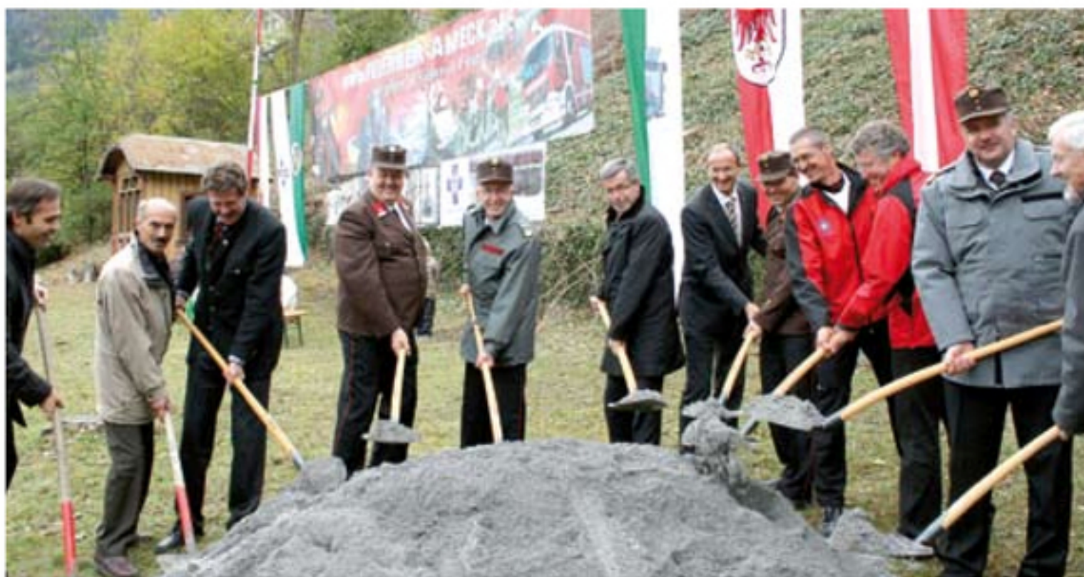
Startschuss: Mit dem feierlichen Spatenstich durch hochrangige Feuerwehrfunktionäre und Politiker begannen die Bauarbeiten am neuen Landecker Einsatzzentrum.
