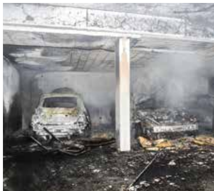
Durch die enorme Hitze kam es zu Abplatzungen der Betondecke bis zur Armierung.
