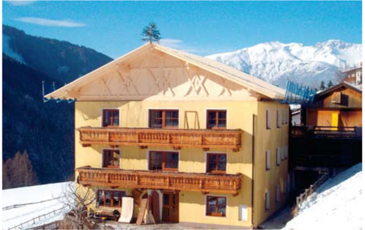
50 Stunden nach dem Brand schien wieder die Sonne auf den Geirhof in Navis, nachdem viele fleißige Hände im Rekordtempo das zerstörte Dach erneuert hatten!
