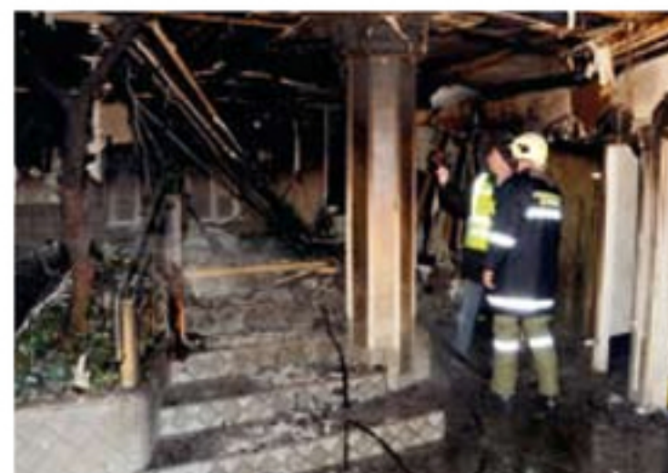
Beträchtlicher Schaden entstand beim Saunabrand in einem Hotel, bei dem 140 Hotelgäste sicherheitshalber evakuiert werden mussten!
