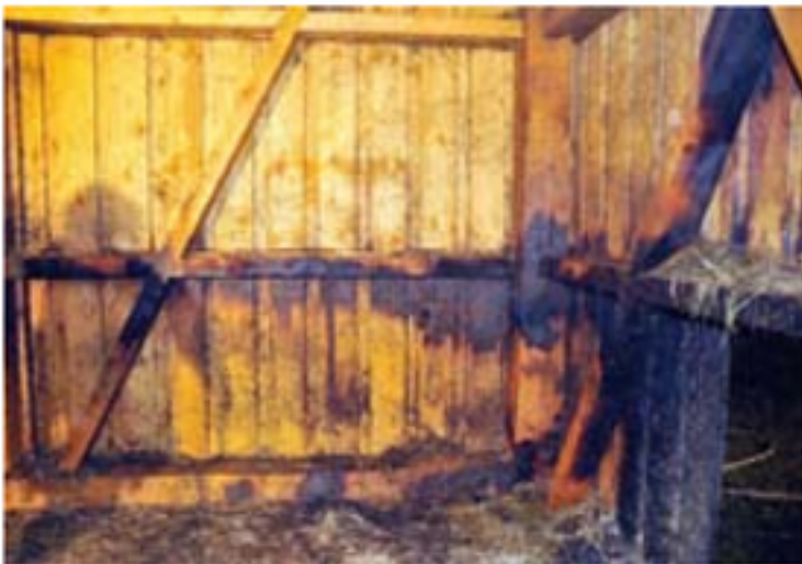
Vorbildlich: Brand wurde rasch eingedämmt.
