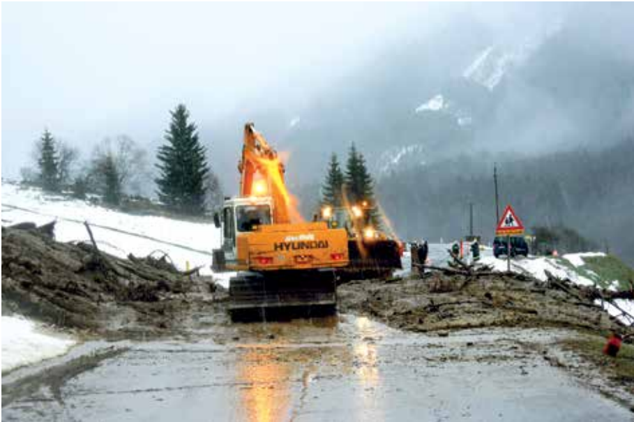
Aufräumarbeiten nach Vermurung auf Straße. Die Gefahr weiterer Mureinstöße muss geprüft werden, bevor die Aufräumarbeiten beginnen können.
