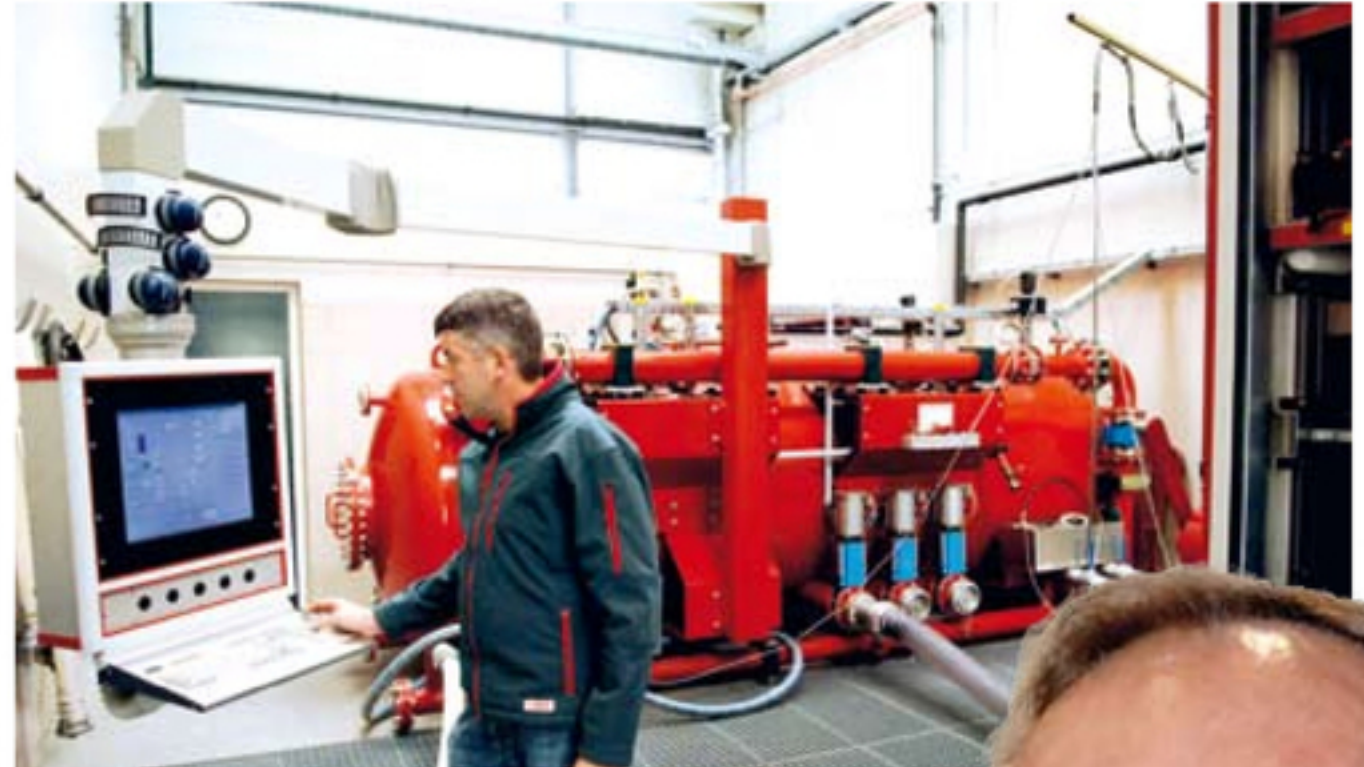
EMPL exklusiv: Am Pumpenprüfstand gibt es keine Kompromisse, sondern nur knallharte Fakten anhand der Analyse mittels modernster Prüftechnik!
