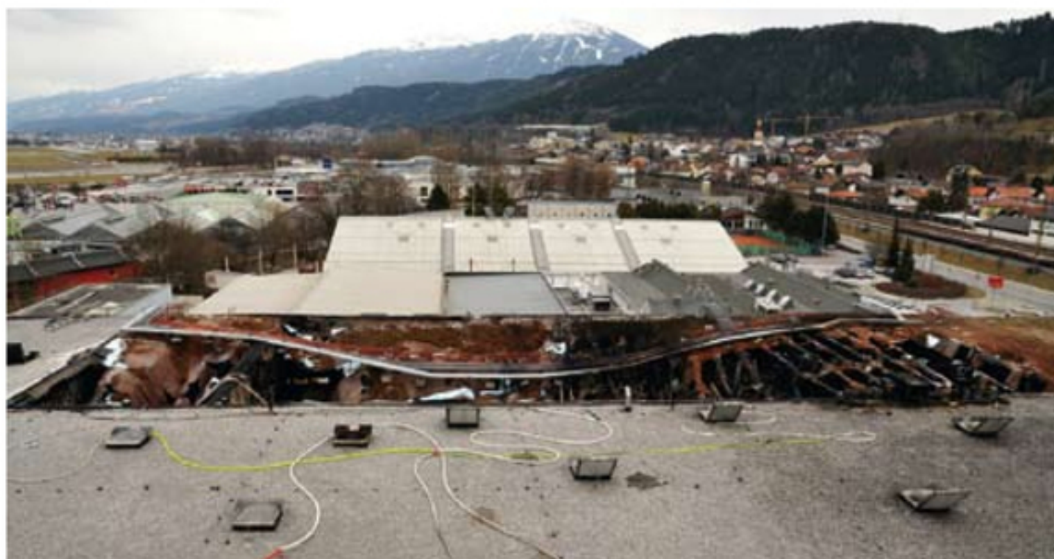
Am Tag danach: Ein riesiges Loch klafft im Dach der Halle – der Bürotrakt und auch der Westteil konnten durch die unermüdliche Arbeit aber gerettet werden!
