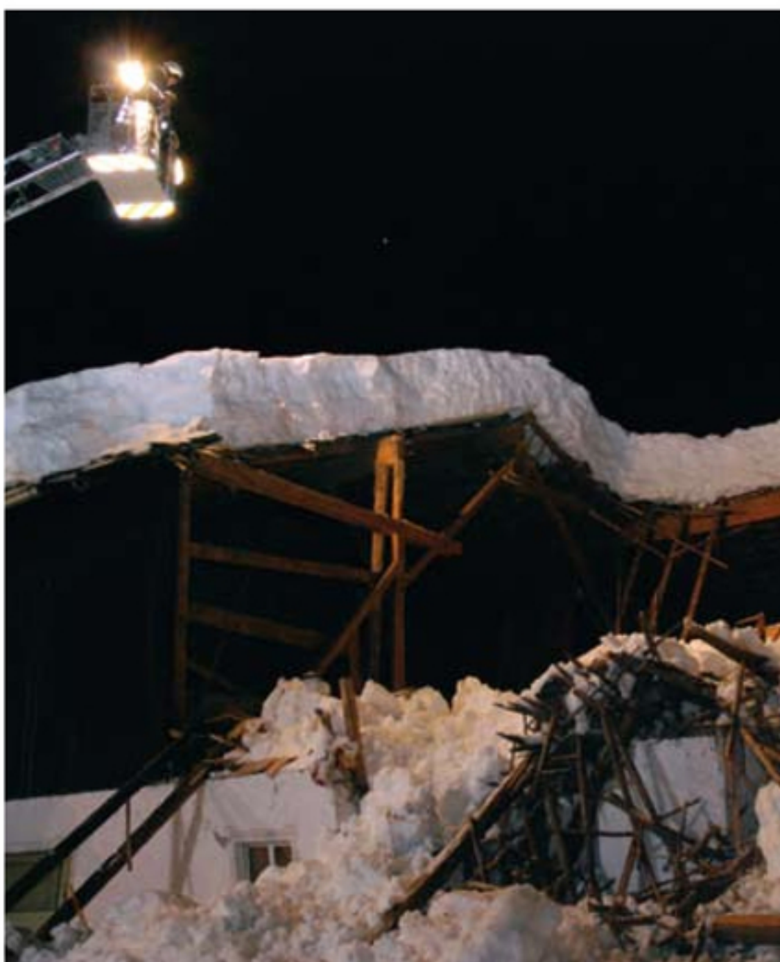
In Leutasch stürzte ein Teil eines Tennengebäudes in sich zusammen – weitere Schäden konnten verhindert werden.
