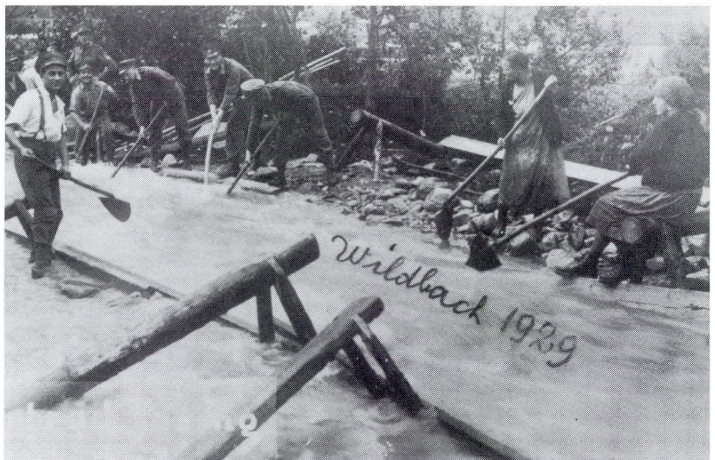
Abwehrarbeiten bei der Mure von 1929, bei denen auch Militär eingesetzt war.
